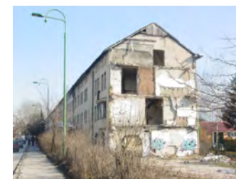
SLIKA 13 Jedna od zgrada bivše kasarne Maršal Tito, srušena 2008 zbog proširenja gradskih cesta
